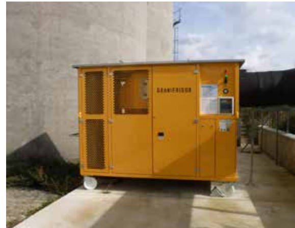
Appareil de réfrigération du silo (photo DRIAAF-SRAL)
